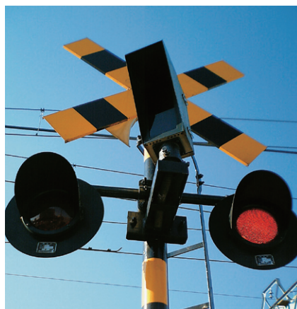
踏切警報灯〈横配置〉
